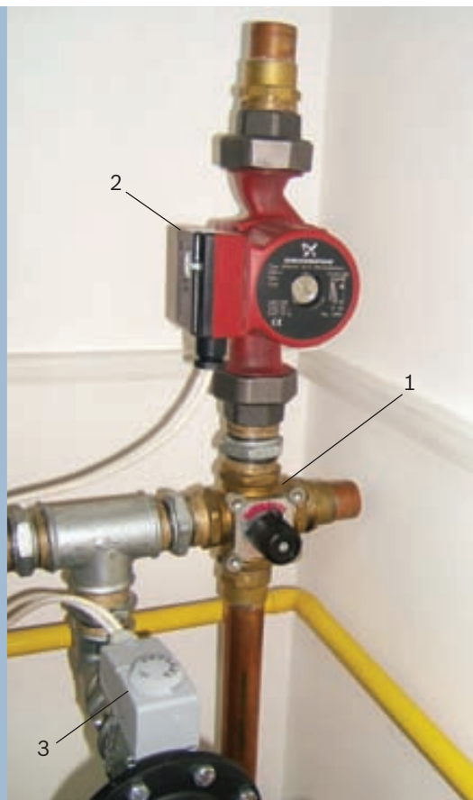
Princip: četvorokraki ventil (1) meša vodu iz povrata i polaza, a cirkulacionu pumpu (2) uključuje kontaktni termostat (3)
